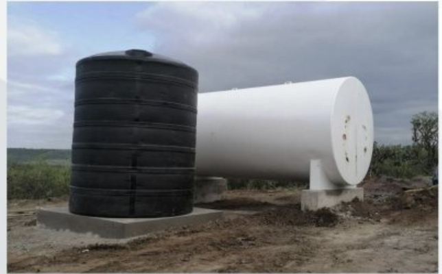
LINEAS E INSTALACIÓN DE TANQUES ELEVADOS SAN JOSÉ DE OLIVARES
