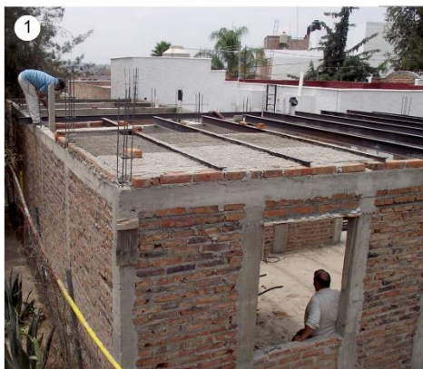
1- Avance de la obra de ampliación del Centro de Salud de la Colonia Mi Nuevo San Juan
